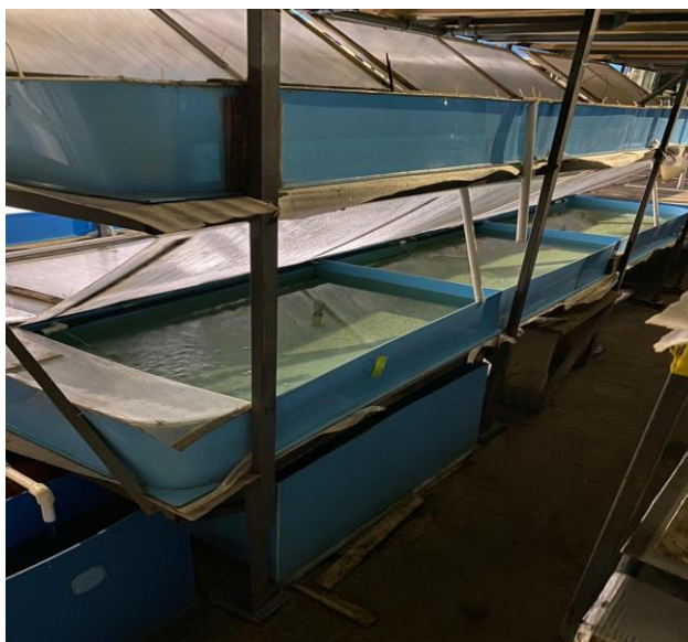
Рисунок 2 - установка замкнутого водоснабжения для выращивания ракообразных
